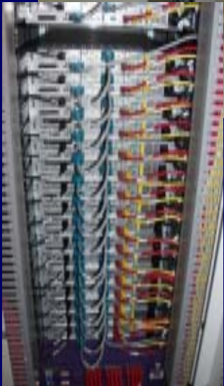
背面ケーブリング
